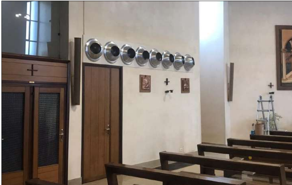
Ugelli a parete direzionabili che consentono di indirizzare l'aria verso tutte le zone della Chiesa.
