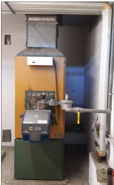
Vecchio generatore di aria calda alimentato a gas, di potenza termica pari a circa 232 Kw — Chiesa.
