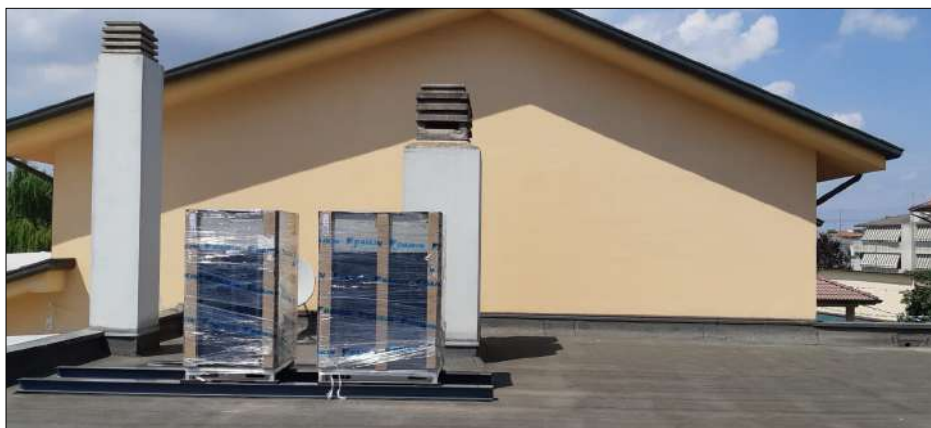
Zona copertura piana sopra alla Centrale Termica e Sacrestia — posizionamento delle unità esterne DAIKIN.
