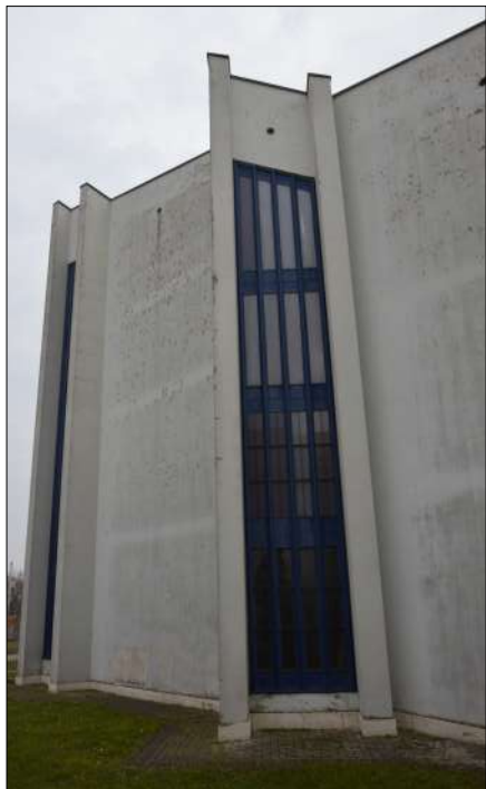
Stato di fatto prima dei lavori di sostituzione dei serramenti e realizzazione del cappotto termico.
