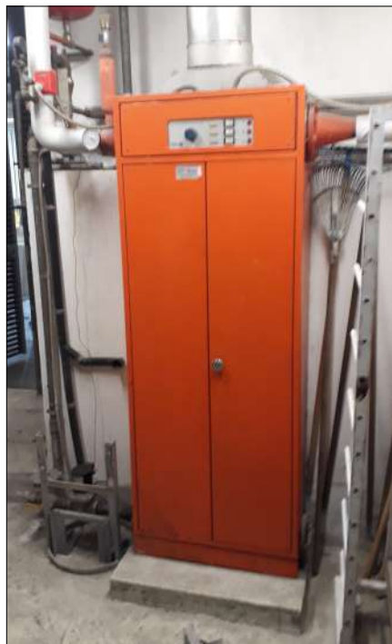
Attuale generatore a gas di potenza termica pari a circa 105 Kw — Patronato e Cappella Feriale.
